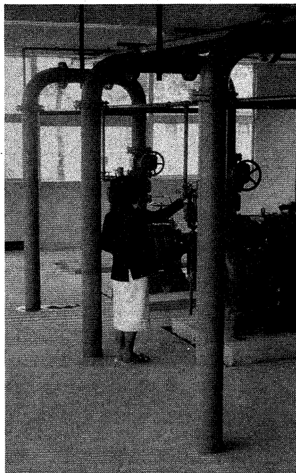
5台の大型ポンプが設置されたポンプ室
