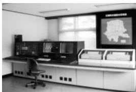
浄水場中央監視室
