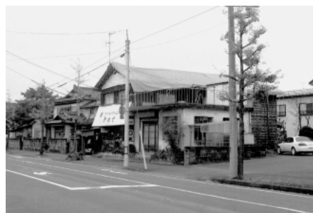
大部分の棟瓦等のずれ及び落下
