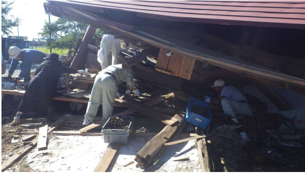
写真：崩落した地蔵堂内部からの仏像救出
